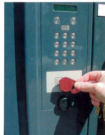
PLATINE INTERPHONIE ET LECTEURS DE BADGES DE PROXIMITÉ constituent les piliers du système de sécurité. C'est le régisseur qui gère les droits d'accès des badges et les 1 000 passages enregistrés chaque jour. (Doc. OPHLM de Clichy-la-Garenne.)
